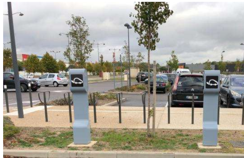
Bornes de recharges pour véhicules électriques au sein de la ZAC Chêne-St-Amand Source : Chargemap
